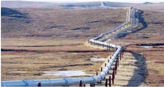
रक्सौलदेखि अमलेखगञ्जसम्मको पेट्रोल ल्याउने पाइप
